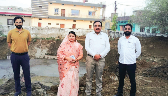
वार्ड क्रमांक 32 में अमृत 2.0 योजना के तहत बन रही 10 लाख लीटर क्षमता की पानी की टंकी का नगरपालिका अध्यक्ष प्रीति राकेश शर्मा ने निरीक्षण किया।
